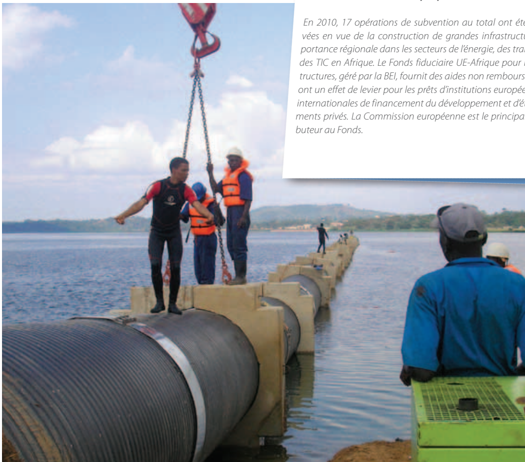
Pipeline marin de Gaba, près de Kampala (Ouganda)
